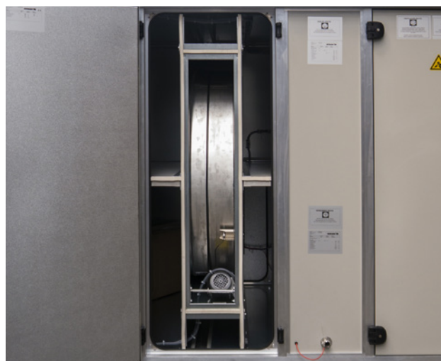
Warmtewiel in de unit (zij aanzicht).
