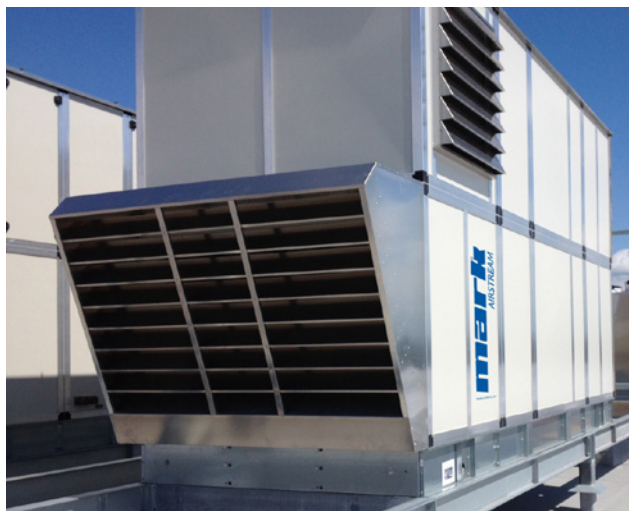
Luchtaanzuigkap op de unit.
